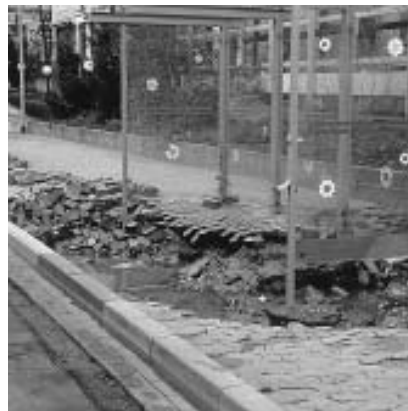
Straßen und Bürgersteige wurden durch die Kraft des Wassers aufgerissen - wie hier in der Kaiser-Wilhelm-Straße
