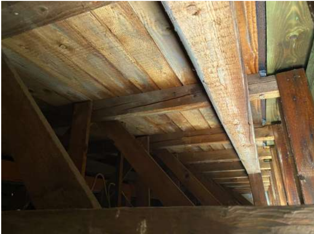
Bild 15: Die Gebäudestrukturen im Inneren des Dachstuhls ohne Nachweis wiederkehrend genutzter Nester
