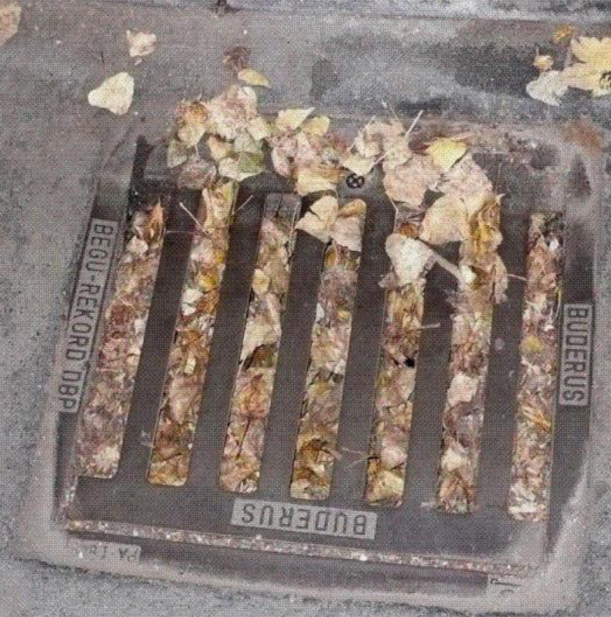
Verstopfter Gully Quelle: Hydrotec GmbH
