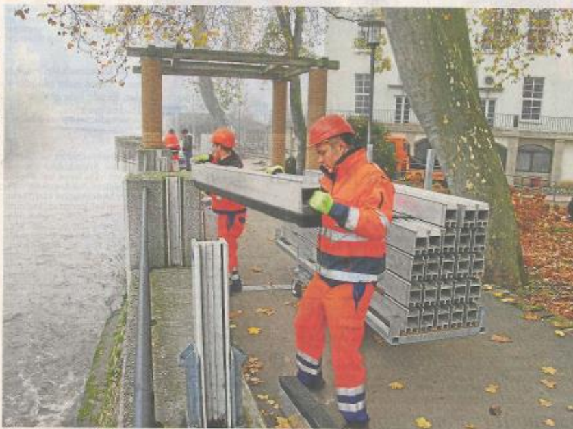
Jeder Handgriff muss sitzen, wenn es gilt, die Stadt Bad Kreuznach vor Hochwasser zu schützen. Bei einer Großübung arbeiten am Dienstag Bauhof, Tiefbauabteilung und Feuerwehr zusammen. Bewährtes Mittel zur Gefahrenabwehr sind die mobilen Dammbalken aus Aluminium.
