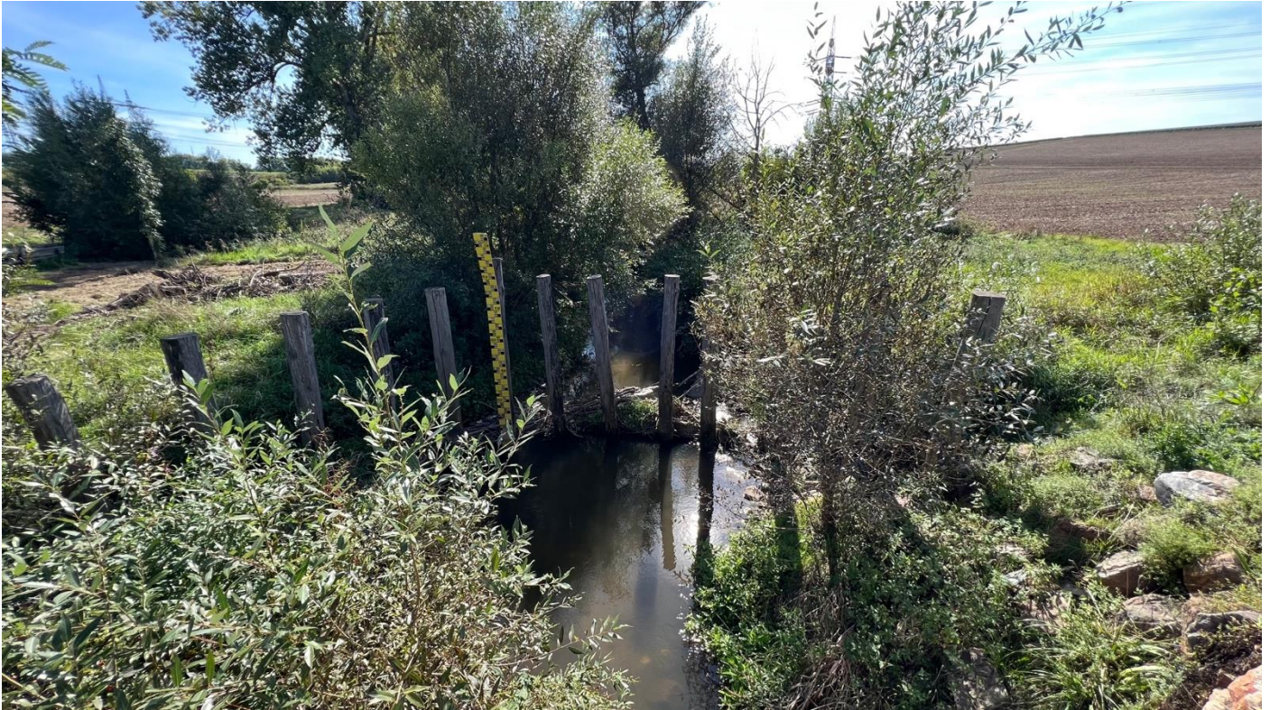
Abbildung 9: Treibgutsperre Polder Badenheim im September 2023 (Quelle: Heinrich Webler 25.09.2023)
