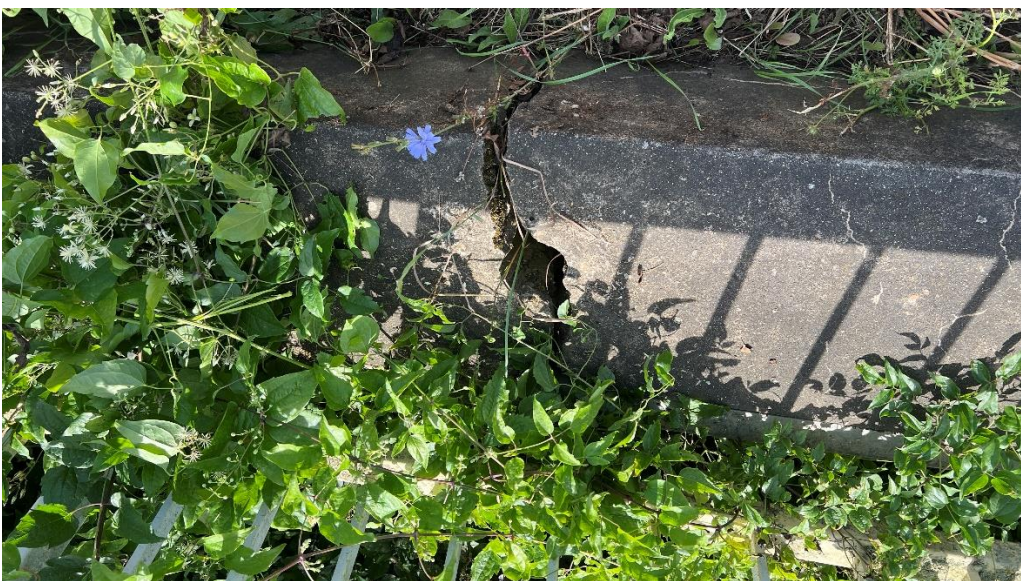
Abbildung 39: Risse im Beton der Brücke
