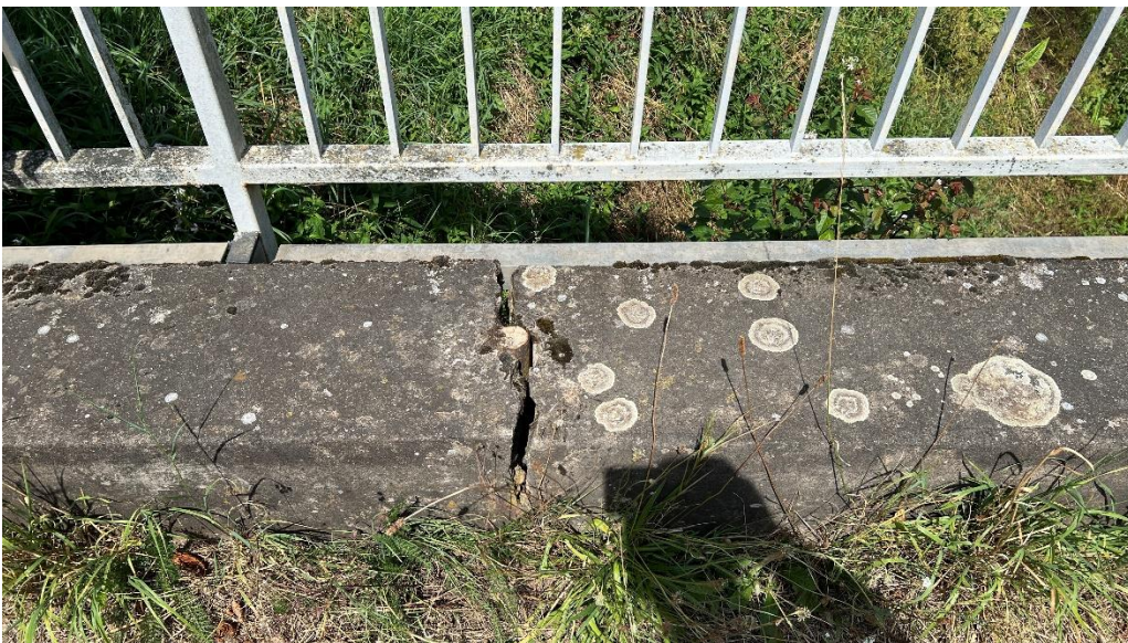
Abbildung 38: Risse im Beton der Brücke
