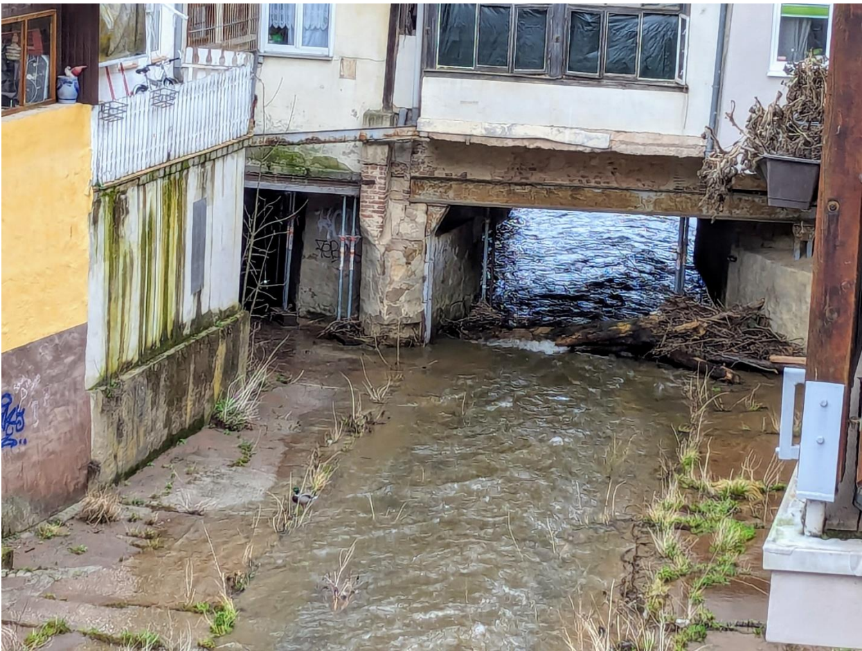
Abbildung 15: Aufstau von Treibgut bei einem Hochwasser am 23.02.2024 (Quelle: Norbert Wortmann)
